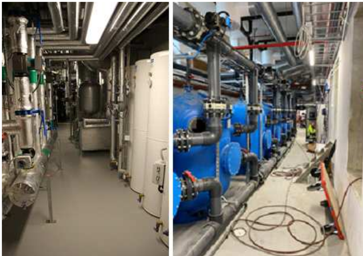
Bilde: Byggeindustrien v/Arve Brekkhus, tekniske rom Nittedal u-skole. Bilde to er teknisk rom til bassengene på Elvetangen.
